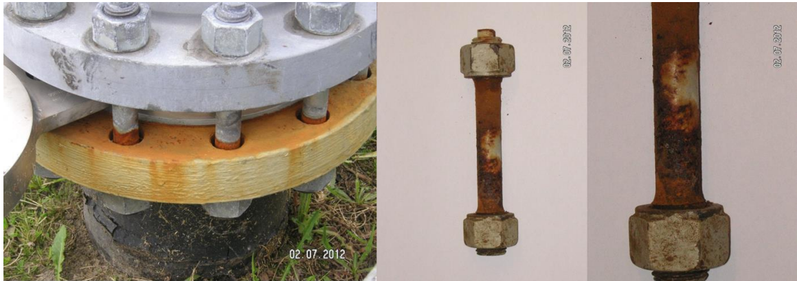
Abb.4: Korrosionsproblem an waagerechten Flanschen in Außenanlagen
