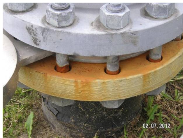
Abb.2: Korrosion an Schraubverbindungen in den unteren Löchern waagerechter Flansche in Außenanlagen Quelle: Peter Thomsen
