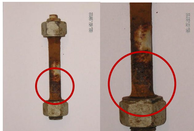
Abb.1: Korrosionsproblem an Schraubverbindungen in waagerechten Flanschen in Außenanlagen Quelle: Peter Thomsen
