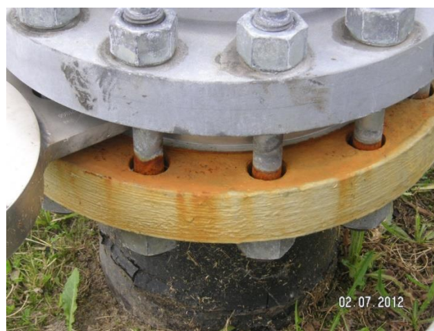
Abb.2: Korrosion an Schraubverbindungen in den unteren Löchern waagerechter Flansche in Außenanlagen Quelle: Peter Thomsen
